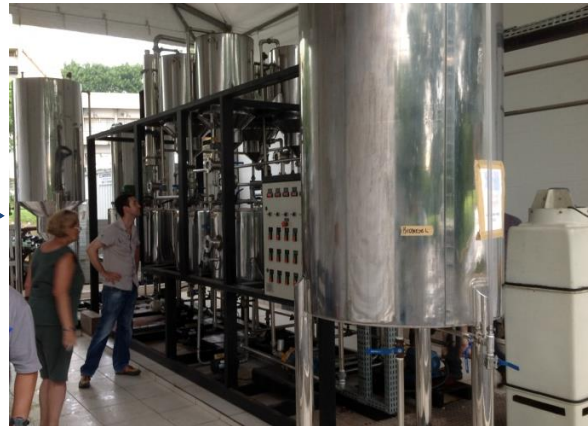
Usina de tratamento de óleo residual e produção do biodiesel
